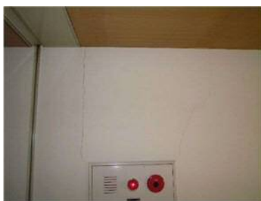
内壁ひび割れ
