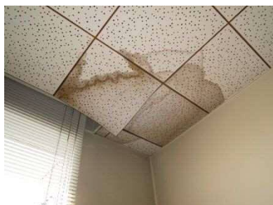
天井雨漏り跡
