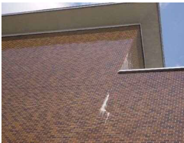
外壁ひび割れ
