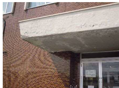
出入口の庇の剥離
