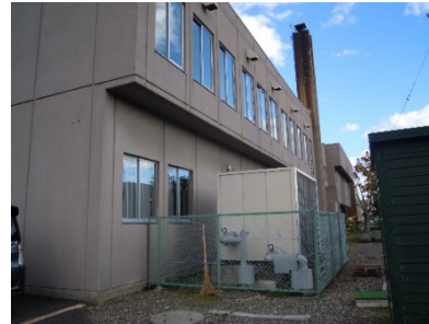
水冷式冷暖房設備
