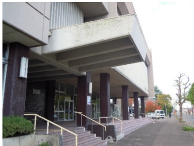
玄関入口の段差 庇の剥離
