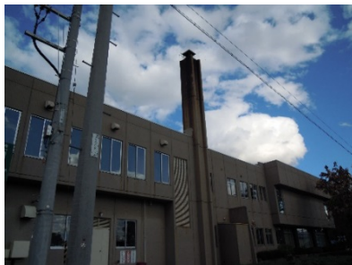
アスベスト含有のボイラー煙突
