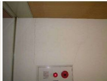
内壁のひび割れ
