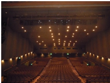
取替え困難で切れたままの天井の照明
