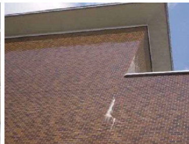
外壁のひび割れ
