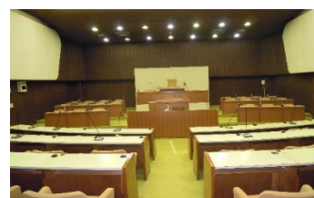
議場 天井に吹付アスベスト使用
