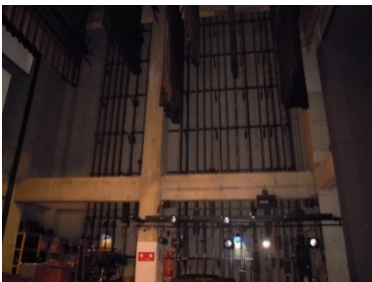
老朽化した舞台設備
