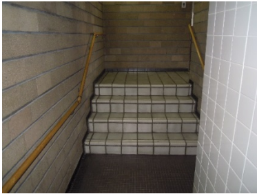
大ホールトイレ入口の段差
