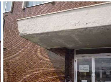
出入口の底の剥離
