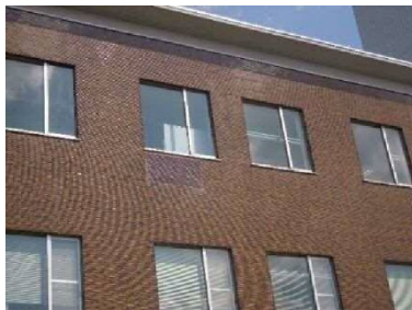
外壁落下による補修跡
