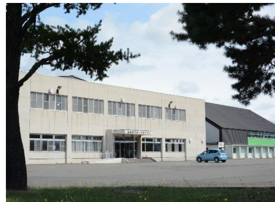
インフラ・公共施設の老朽化
